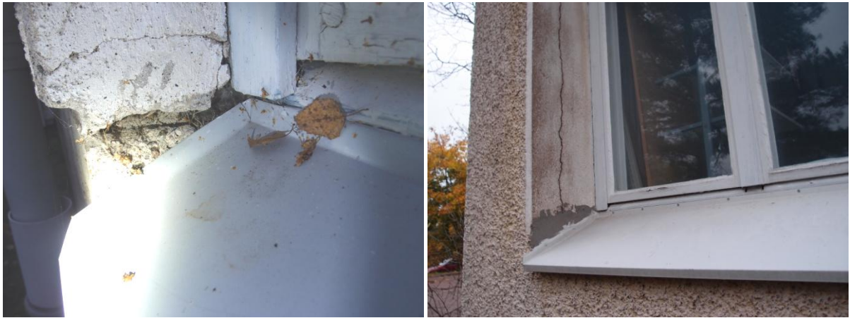
Kuvat 1 ja 2. Alkuperäisiin puuikkunoihin liittyy korjaustarve lähiaikoina. Ikkunoiden alareunat ovat monin paikoin huonokuntoiset.
