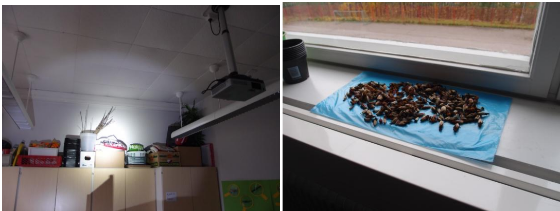
Kuvat 5 ja 6. Luokkatiloissa on pölyä kerääviä tavarapinoja sekä ulkoa tuotuja kasveja, jotka toimivat mikrobilähteinä.
