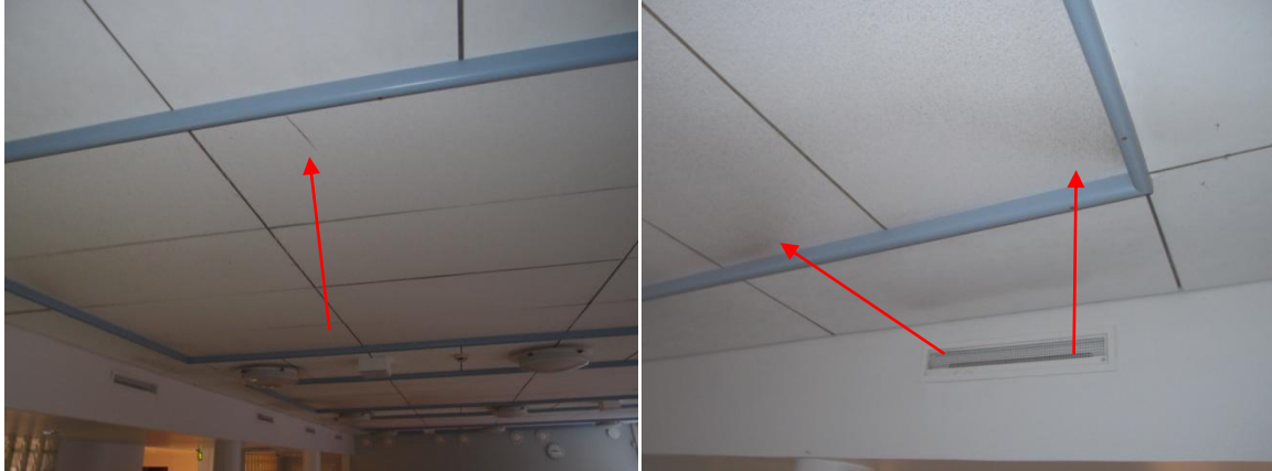
Kuvat 3 ja 4. Tuloilma heiluttaa kattopintaan tarttunutta pölynauhaa. Tuloilman virtaus saa sisäilman epäpuhtaudet tarttumaan villapintoihin.
