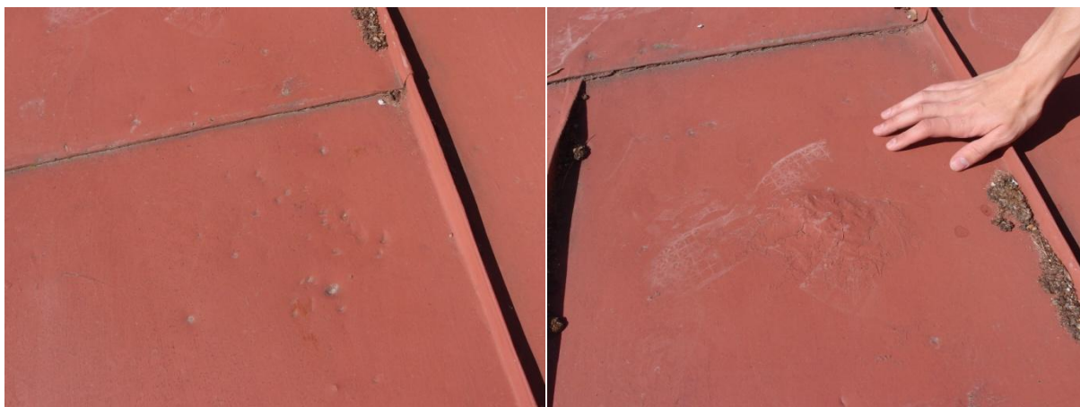
Kuvat 6 ja 7. Naulan kantoja ja painumia sekä maalipinnan vaurioita pellityksessä.
