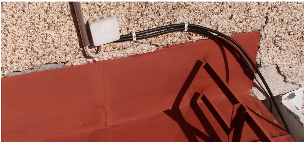
Kuva 5. Reunapellin yläreunassa rappaus on irti, samoin rännin kohdalla.
